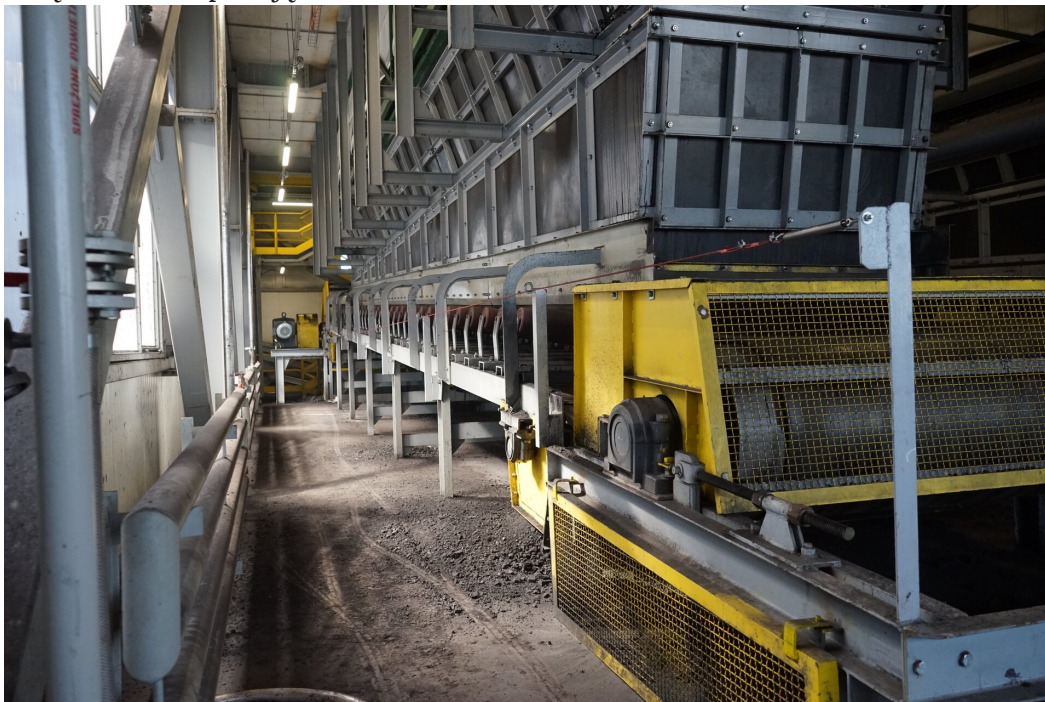
Stacja zwrotna przenośnika taśmowego
