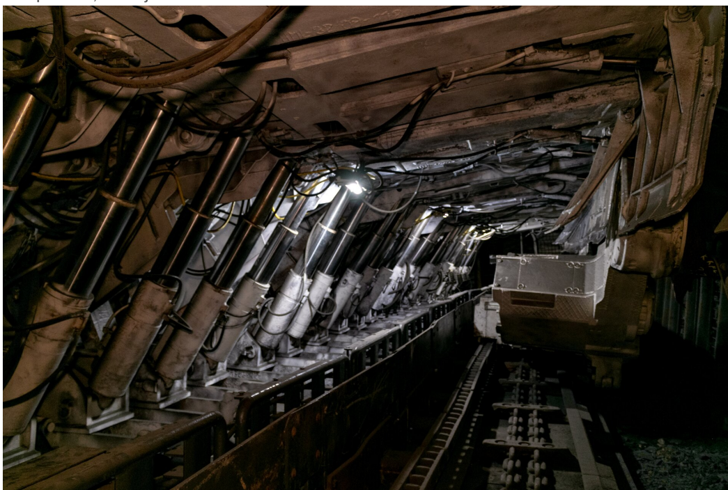
Trasa przenośnika zgrzeblowego w obudowie zmechanizowanej
