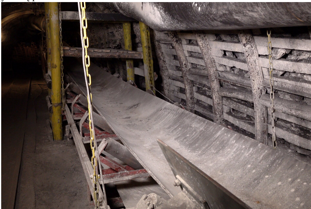
Trasa przenośnika taśmowego
