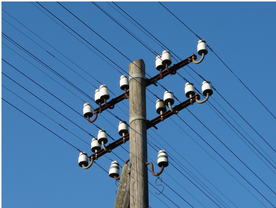
Rys.a. Napowietrzne linie energetyczne są zawsze podtrzymywane na izolatorach zamontowanych na słupach.
