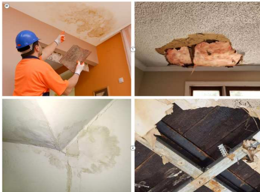
Olejawy uszkodzenia pokrycia dachowego Źródło: Akademia Finansów i Biznesu Vistula, licencja: CC BY 3.0.
