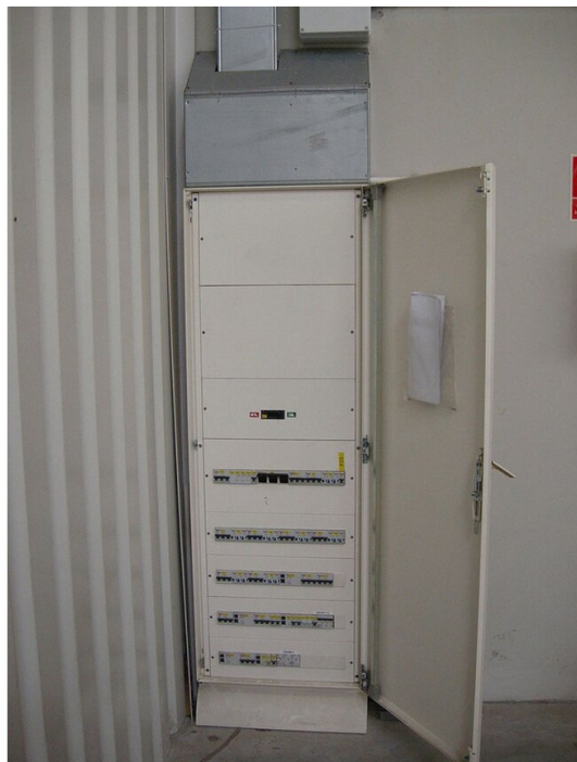
Rys.14 - Rozdzielnia energii elektrycznej
