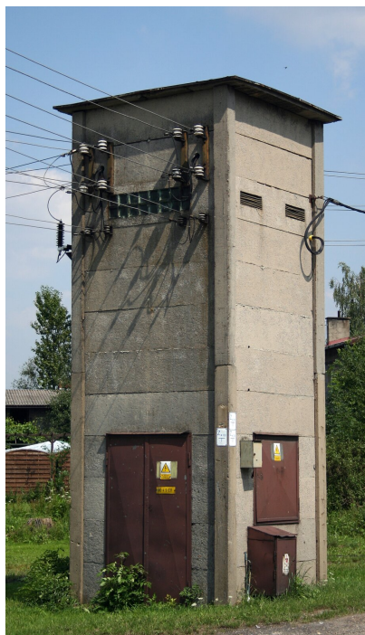
Rys. 4. Wieża transformatorowa w Woli Hankowskiej.
