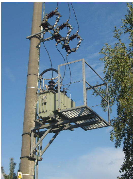
Rys. 3. Stacja transformatorowa słupowa w Marianowie.
