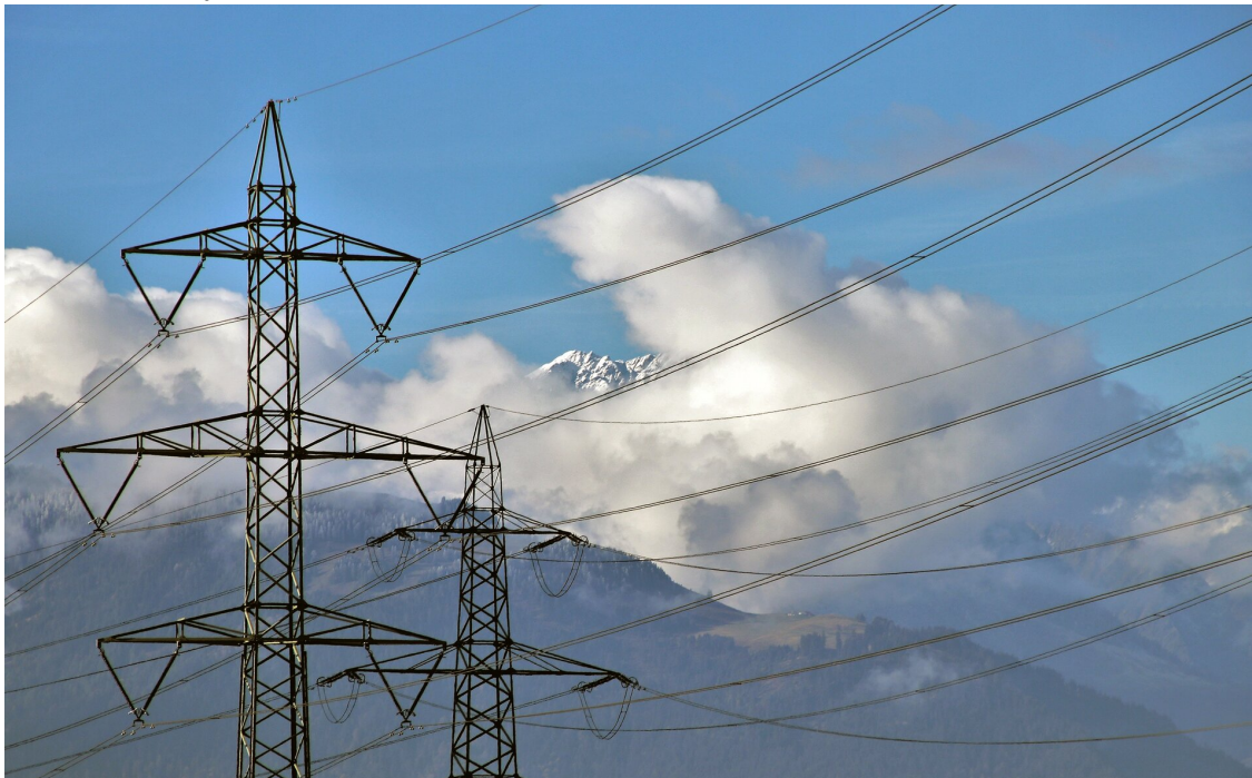
Rys. 6. Linie wysokiego napięcia.
