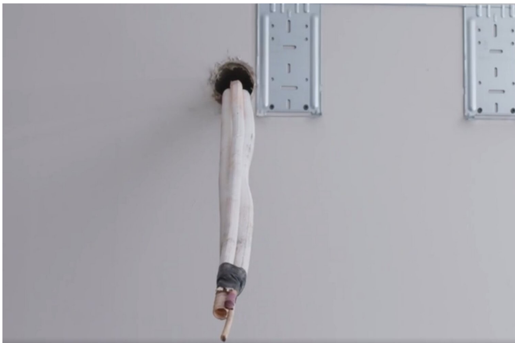
Zdj. 5. Wiązka rur i przewodów przełożona przez przepust w ścianie
