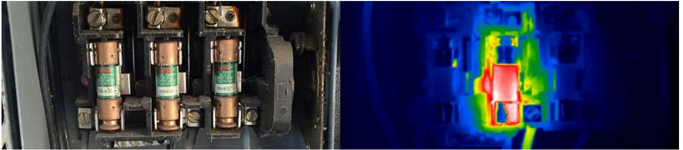
Rys. 2. Jeden z elementów jest uszkodzony, gdyż nadmiernie się nagrzewa. Źródło: https://blog.etservis.pl/badania-termowizyjne-elektrotechnika/
