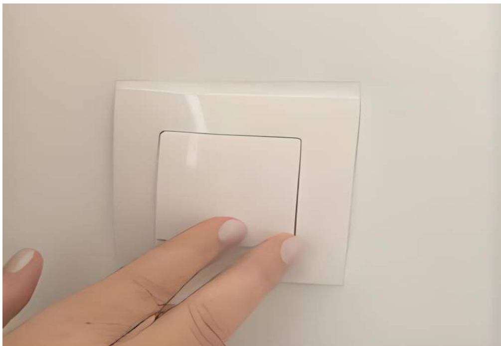
Załączanie obwodu oświetleniowego
